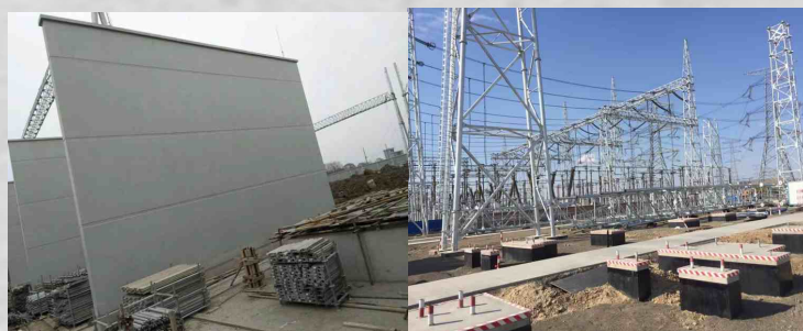
新疆电力公司家电网 乌北750KV变电站
