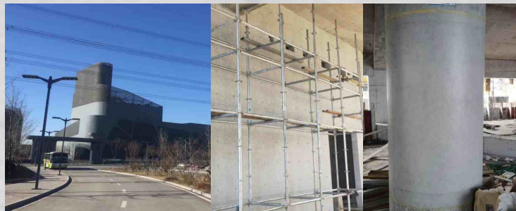
神华国华高安屯燃气热电(神华集团样板工程)
